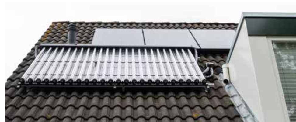
Zonnepanelen en vlak daaronder de zonnecollectoren
