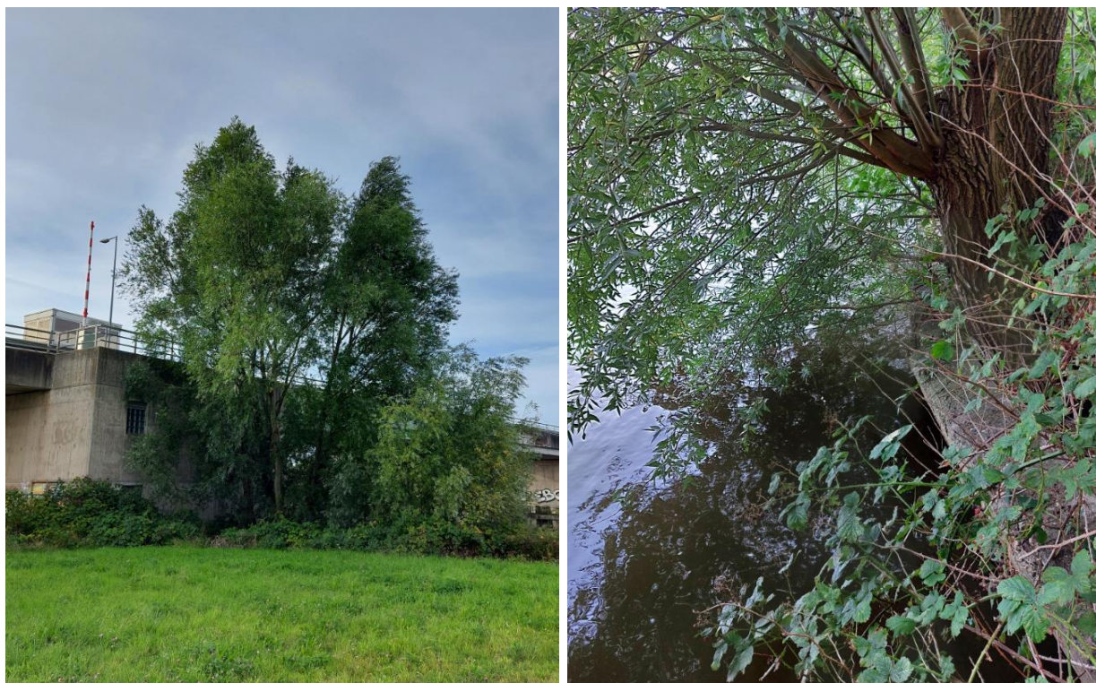
Figuur 5.6 Wilg Busbaanbrug (links) en weggedrukte kade (rechts). Bron: Inspectierapport gem. Groningen 19 september 2023
