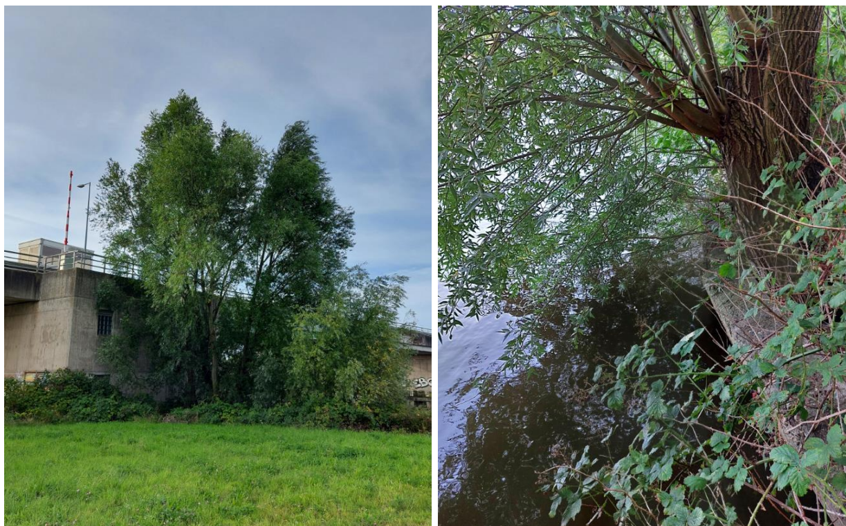
Figuur 5.6 Wilg Busbaanbrug (links) en weggedrukte kade (rechts). Bron: Inspectierapport gem. Groningen 19 september 2023
